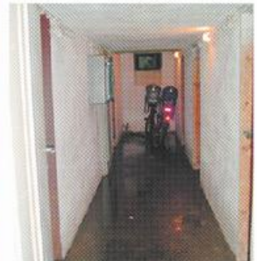
In Althofen wurden zahlreiche Keller überschwemmt
