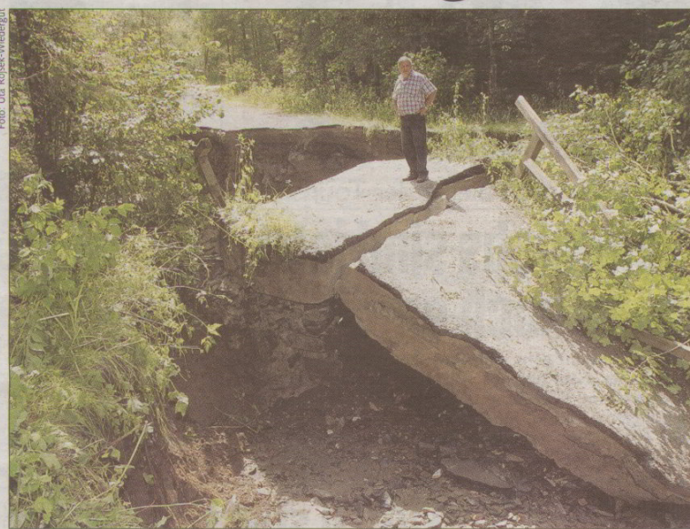
Der Hochfeistritzbach hat die Straße nach Hochfeistritz auf einem Teilstück komplett weggerissen
