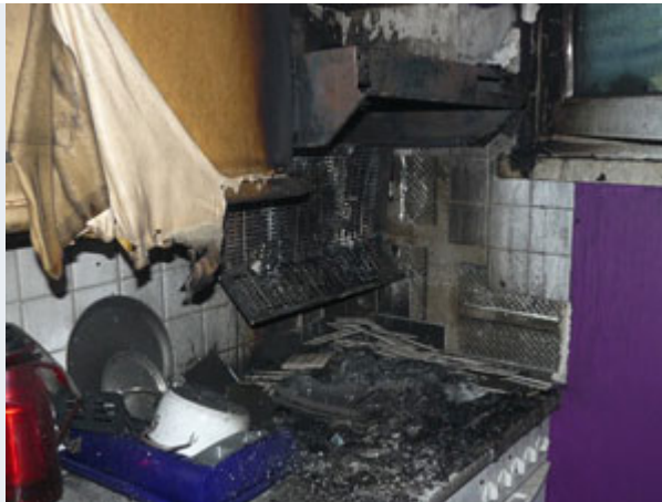
Die zerstörte Küche. Bild: FF Althofen.
