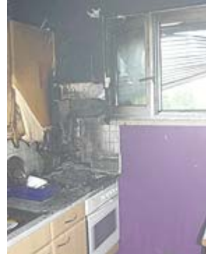
Durch das Fenster zog der Rauch ab und verrußte auch die Fassade Foto: FF Althofen
