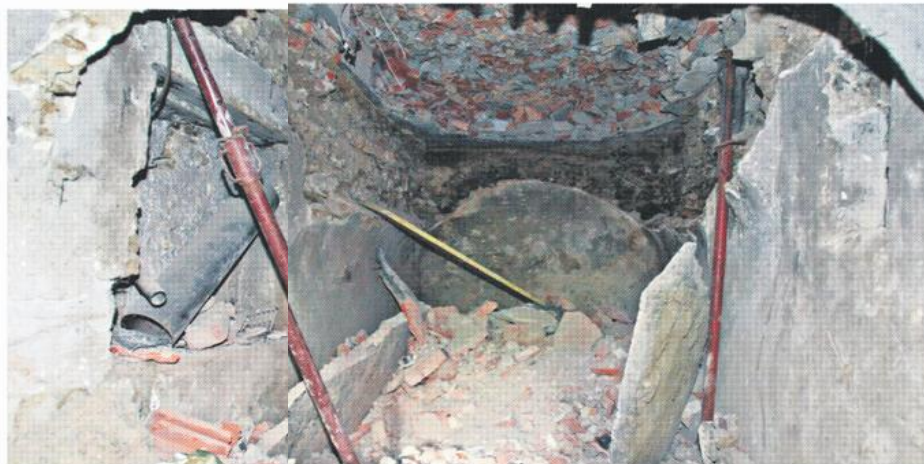
In diesem Kellerraum kam es gestern Früh zu dem Unglück. Die Trümmer und Trümmerteile wogen rund fünf Tonnen EGGENBERGER (2)
