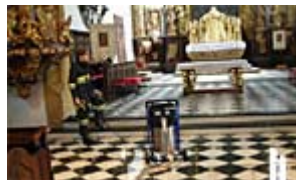
Stadtpfarrkirche Straßburg wurde durch den Regen in Mitleidenschaft gezogen Foto: FF Straßburg
