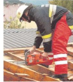
Sturmschaden am Autobusbahnhof in Feldkirchen am 12. Oktober 2009
