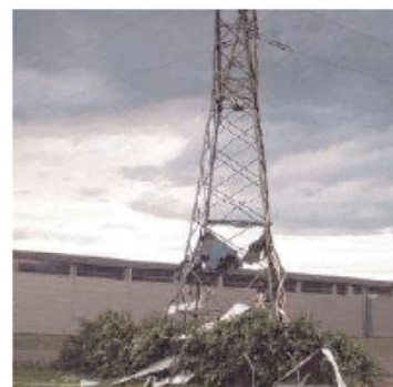
Nach Sturmschäden gilt es für die Feuerwehr zu sichern und aufzuräumen
