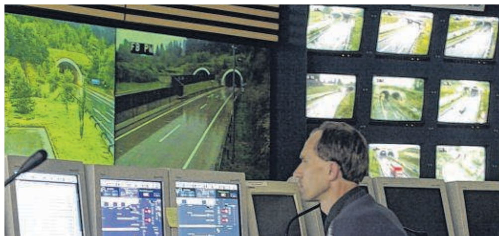
Der Tunnel wird von einer Vielzahl von Kameras überwacht. Damit kann der Operator sofort Alarm schlagen
