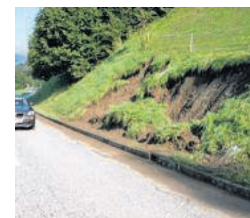
Hangrutschung entlang der Metnitztal Landesstraße
