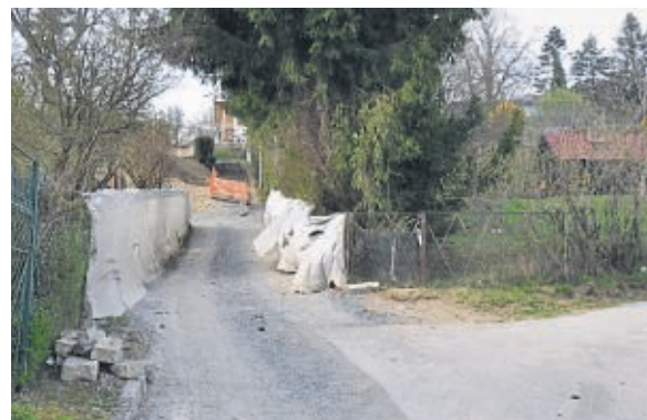
In der Stiegengasse ist nach Bauarbeiten die Stiege abhanden gekommen
