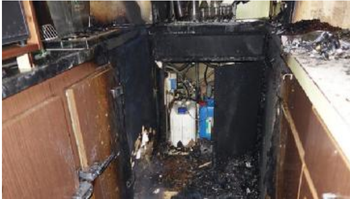
Der gesamte Thekenbereich wurde durch die Flammen zerstört.
