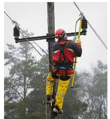
Der Sturm legte mancherorts die Stromversorgung lahm
