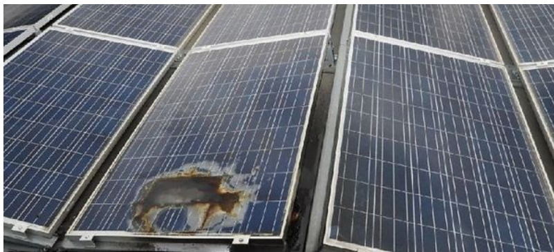
Ein Fotovoltaikpaneel brannte Foto © www.ff-friesach.at
